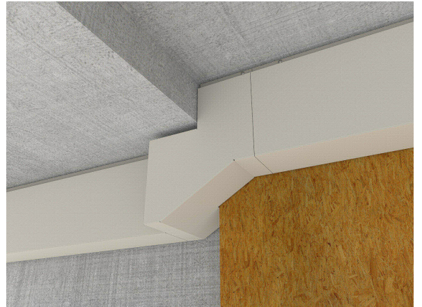
Deckenkanal mit Umfassung
